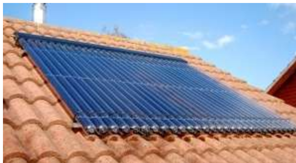
Figure 62 : Panneaux solaires thermique
